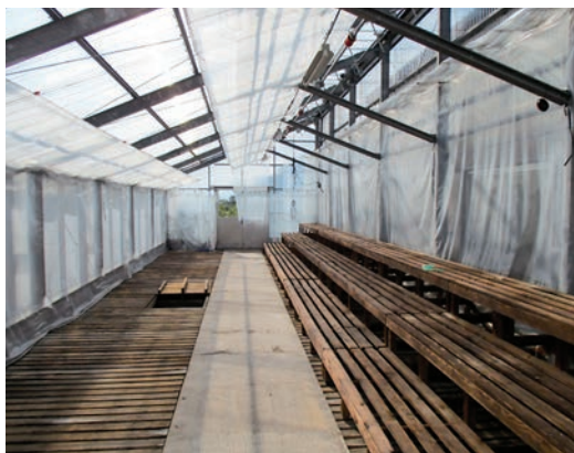
写真11 「さくらセンター」の促成室の内部 17. 9. 5撮影
