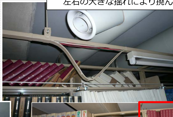
左右の大きな揺れにより撓んだ配線バー
