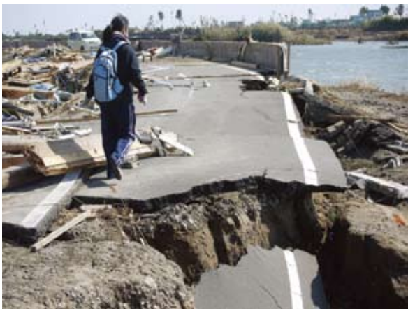
写真3 同上 破壊された護岸堤防
