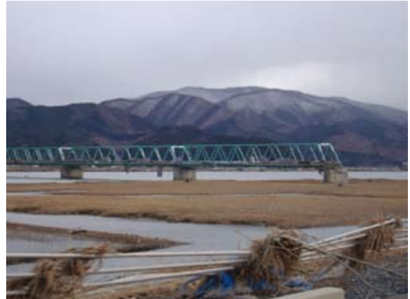
写真4 北上川と崩落した北上大橋 (2011.3.18)
